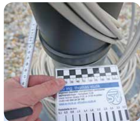
Bild 3: Spalt zwischen Blecheinfassung und Kunststoffrohr.
