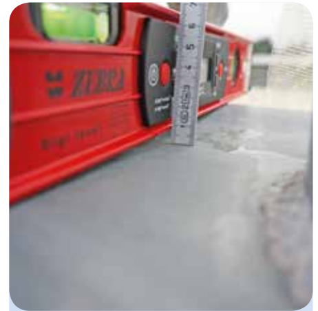
Bild 4: Schachtabdeckung mit unzureichendem Gefälle.
